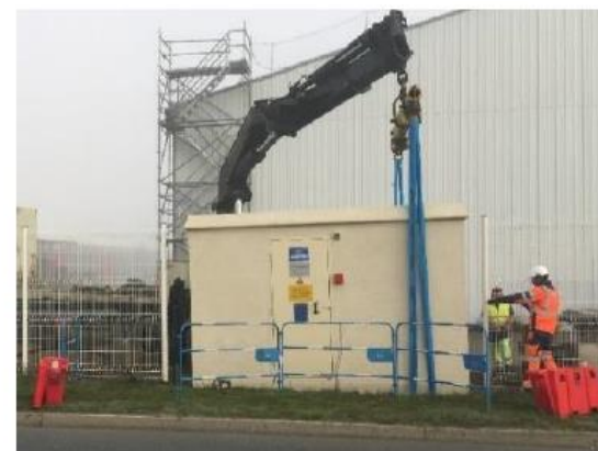
Exemple de poste de transformation – source ENTECH
